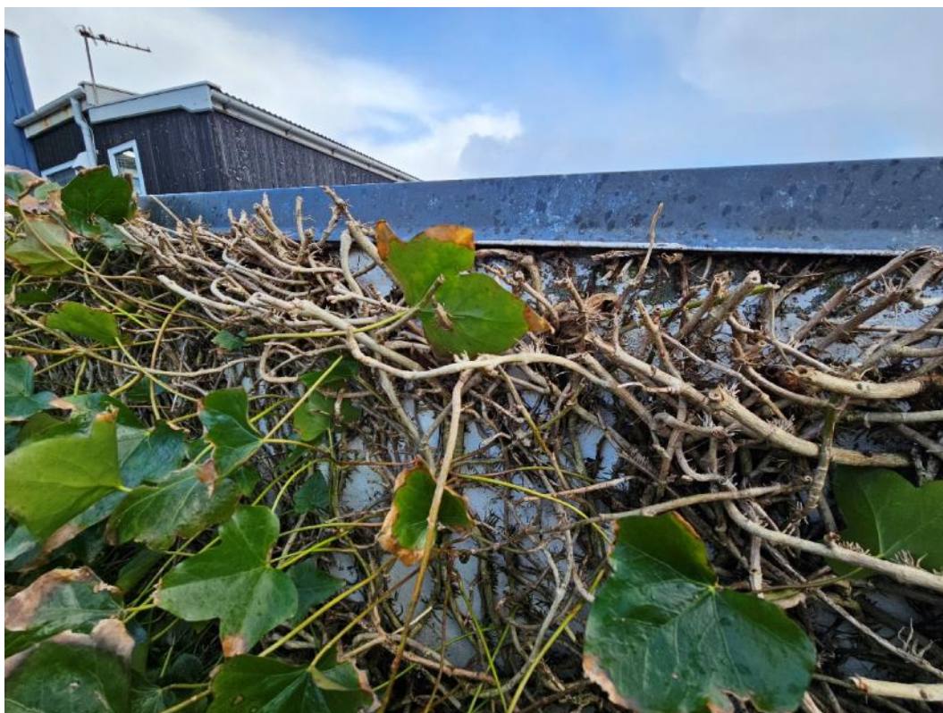
Figure 14: greinar vaksa upp millum betongvegg og inndekning
