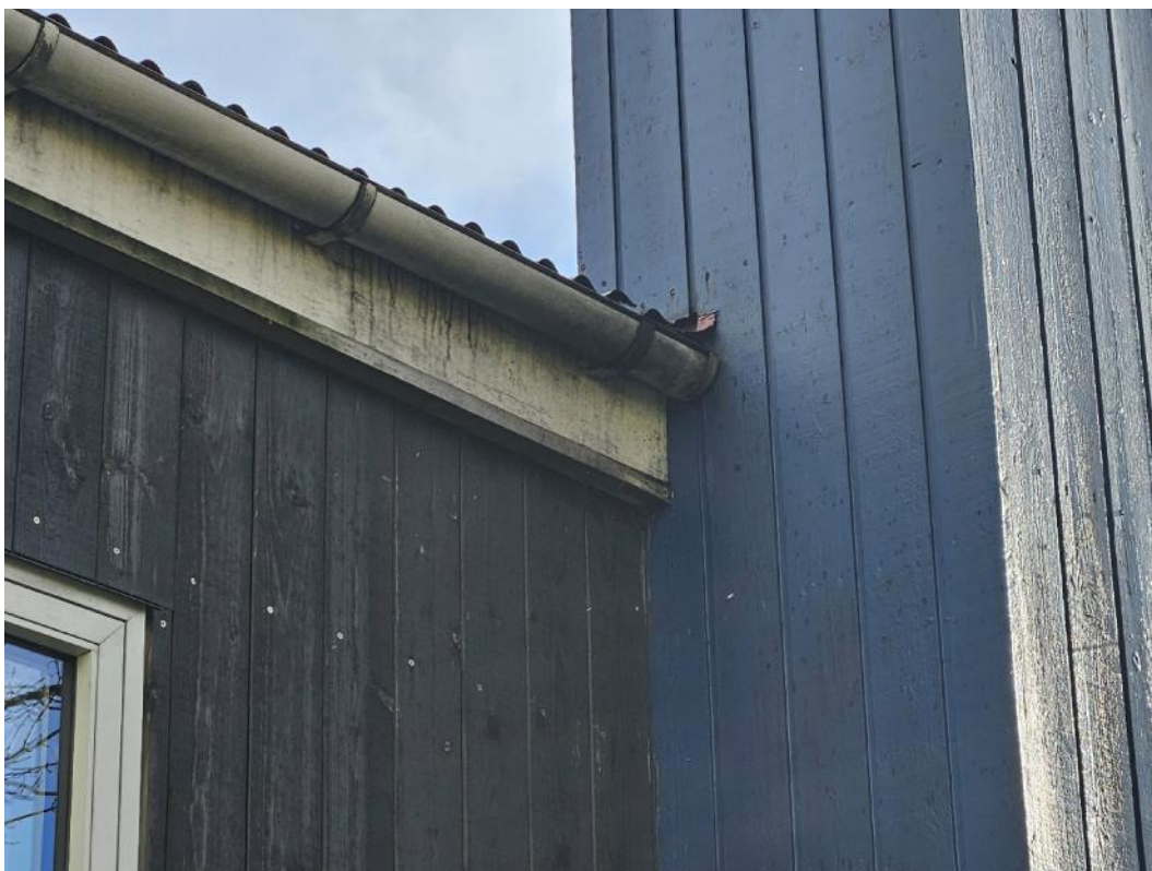
Figure 12: at síggja til er rustur í tekju/inndekning við skorsteinin? Myrkar renningar eru niður eftir sternbrettinum?
