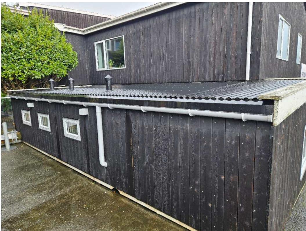
Figure 8: nýggj tekja er lögð á útbygning, har er manglandi takhall
